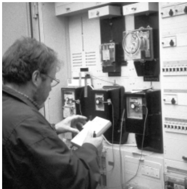
Stromverbrauch und Lastgang werden direkt am Zähler erfasst.
